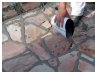
Pavifix CEM Rapid mit einem geeigneten Gießgefäß in die vorbereiteten Fugen einbringen.
